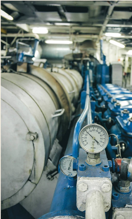
Maskinrummet på Stena Germanica. Tanken är att Stena Germanica under 2020 ska drivas av metanol.
